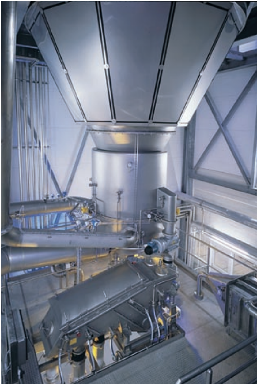
Et moderne spraytørringsanlæg til fremstilling af pulverformige modernælkserstatninger.
